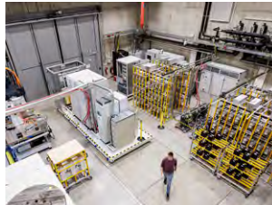
220 m 2 großes Mittelspannungsprüf- feld am Fraunhofer IISB in Erlangen- Halle; Bildquelle: Fraunhofer IISB/ Daniel Karmann
